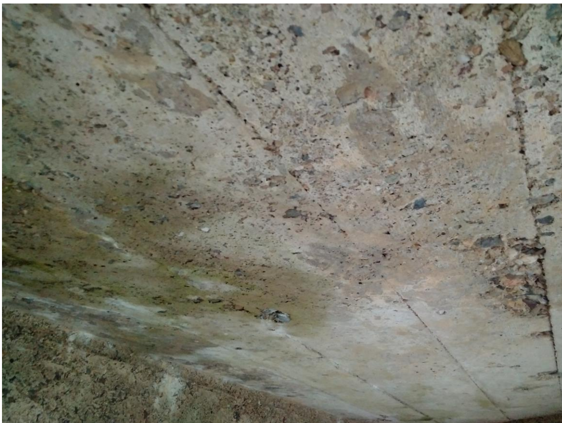
Lokální degradace podhledu nosné konstrukce
